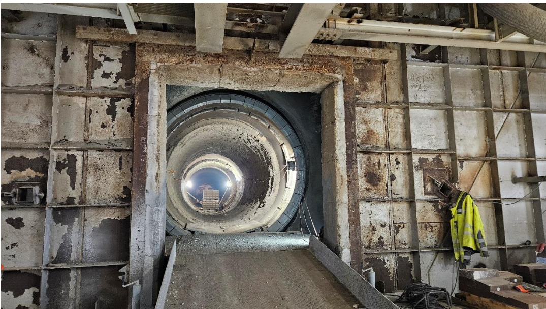
Blick in den Drehrohrofen, der bei der Werksführung im März stilgelegt war. Bei Normalbetrieb wird der das Ofenrohr bis 1.450° C erhitzt © Bernhard Kiesenhofer
